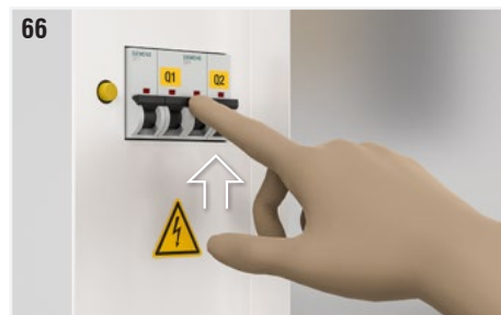
Fig. 66: Compruebe que los interruptores magnetotérmicos para desconectar la alimentación del ventilador (Q1) y desconectar la alimentación auxiliar (Q2) estén en la posición ON.
