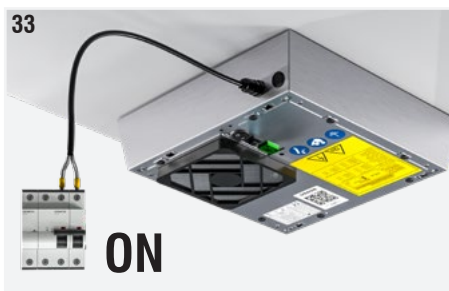
Fig. 37: Agire sul magnetotermico di sicurezza posizionato sul circuito a monte del dispositivo per ripristinare l'alimentazione elettrica.
